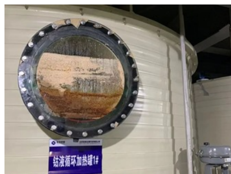
钴液循环加热罐
